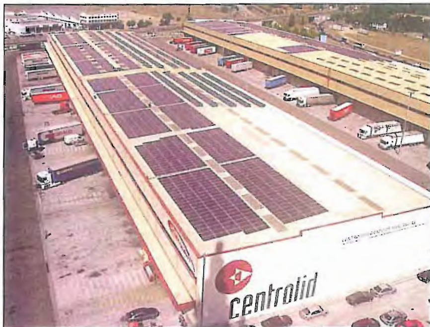
Instalación fotovoltaica en la cubierta de la terminal de transporte de mercancías de Centrolid, en Valladolid.
